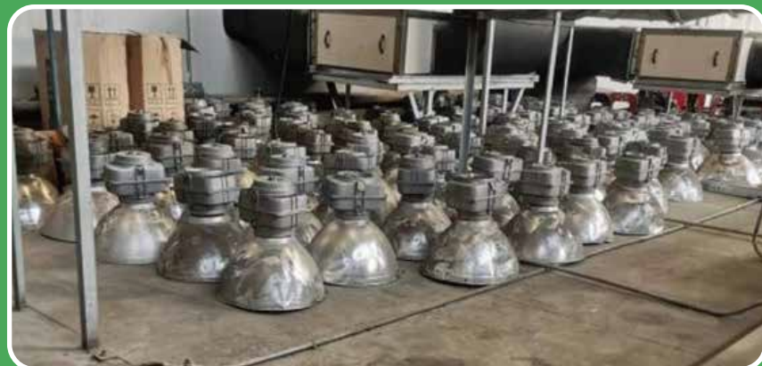
公司车间原本400w金属卤化灯，更换成更加节能的LED照明灯，每年可节省电量77,526度电。
